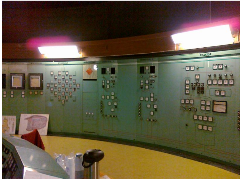
Bild: Kontrollrummet på Ågestaverket (R3)
